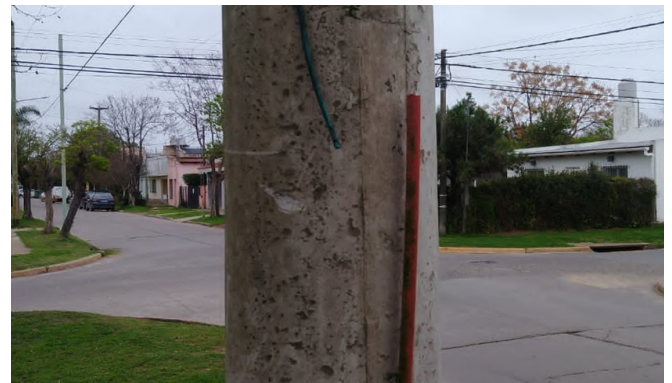
📷 Columna de la CEM vandalizadas.
