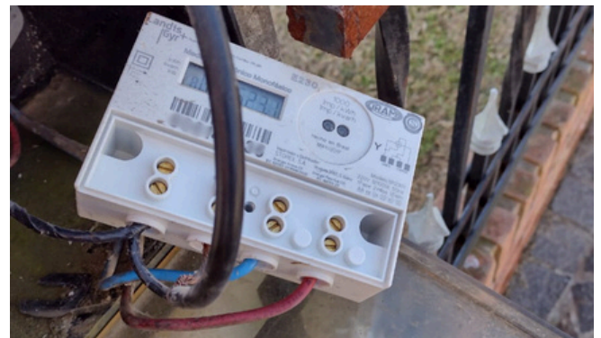
Imágenes de medidores alterados.
